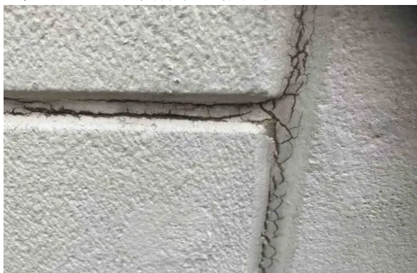
シーリング材の劣化（割れ）
